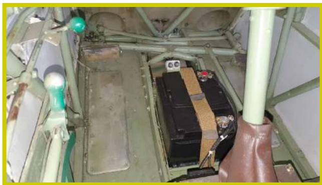
Foto N° 15 batteria per fornire 12 Volt alla radio di bordo e al transponder
